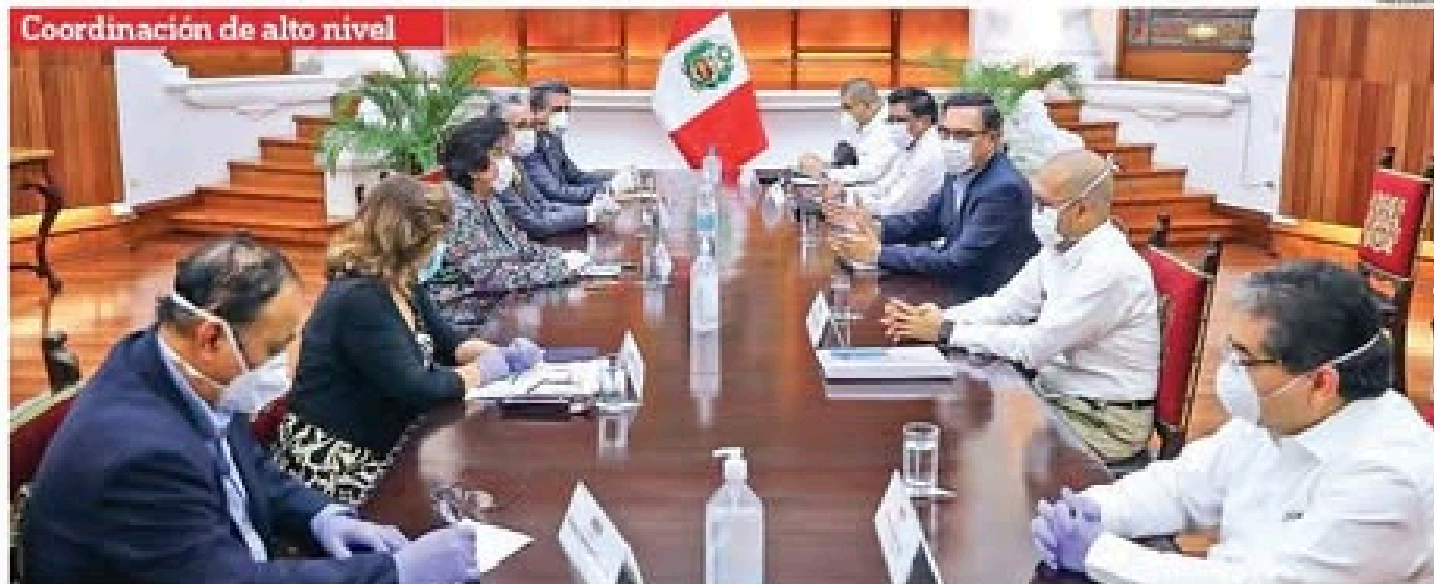
El Mandatario lideró el Consejo de Estado, en el cual se evaluaron las medidas que se ejecutarán en los próximos días para proteger la vida y la salud de la población peruana.
