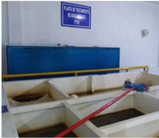
Fotografía 16. Disposición interna de la PTAP, en la que se realizan los procesos de coagulación, floculación y sedimentación. Tomada por Liza Gaitán (2019).
