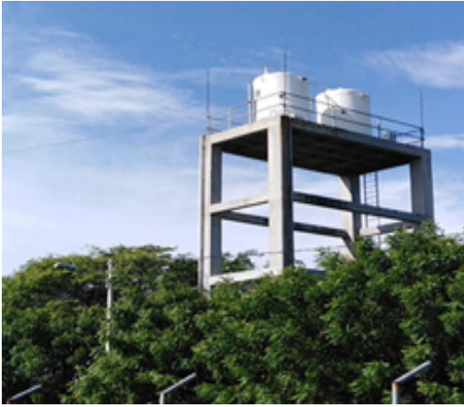
Fotografía 17. Tanques elevados de las comunidades de Roche y Chancleta. Cada uno tiene una capacidad de almacenamiento de 18 000 litros. Tomada por Liza Gaitán (2019).
